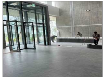
작업자 안전보호구 미착용(뇌연구실용화센터)
