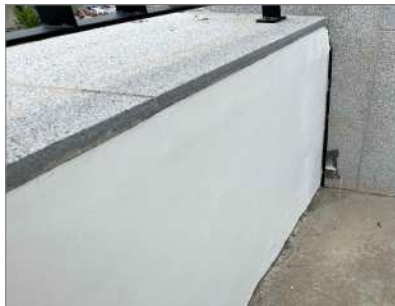
2층 발코니 마감재 이격과다(뇌연구실용화센터)
